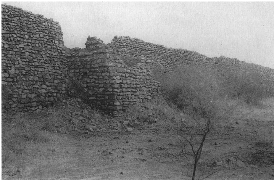
23.3. Ruines d'une tour de défense du tata [forteresse] d' Hamdallahi . [Photo : Institut fondamental d'Afrique noire (IFAN), Dakar.]
